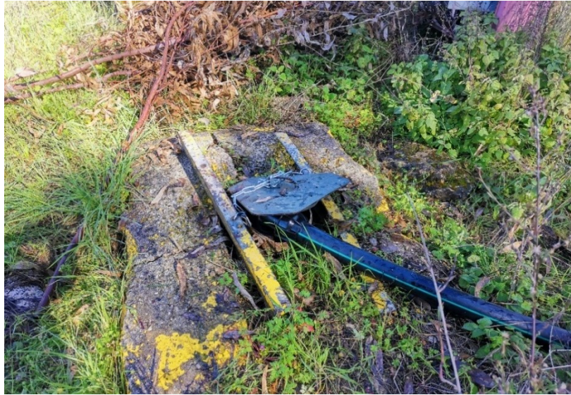
Φωτό4. Είσοδος του σωλήνα μεταφοράς νερού εμπλουτισμού στην γεώτρηση υποδοχής
