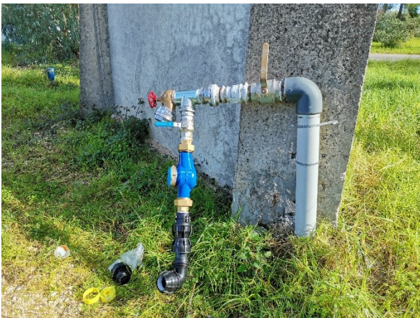
Φωτό5. Αποψη του υδρομέτρου στην εγκατάσταση
